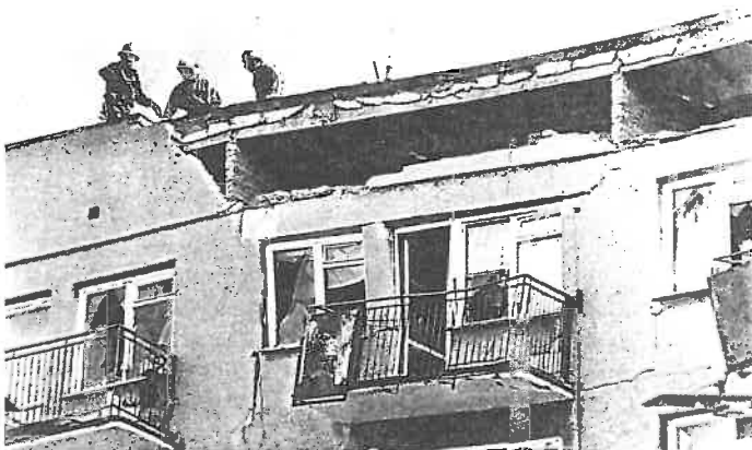
Rys. 9. Fragment uszkodzonego naroża elewacji głównej
