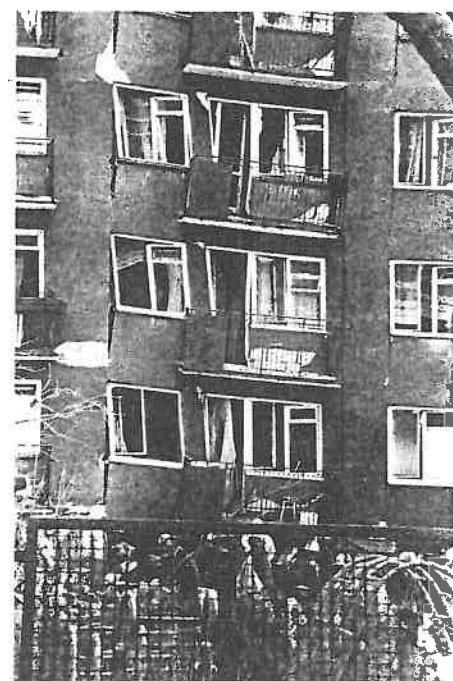
Rys. 11. Fragment dolnej części uszkodzonej ściany osłonowej elewacji głównej
