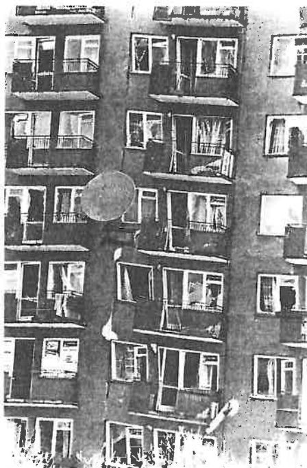
Rys. 10. Fragment górnej części uszkodzonej ściany osłonowej elewacji głównej
