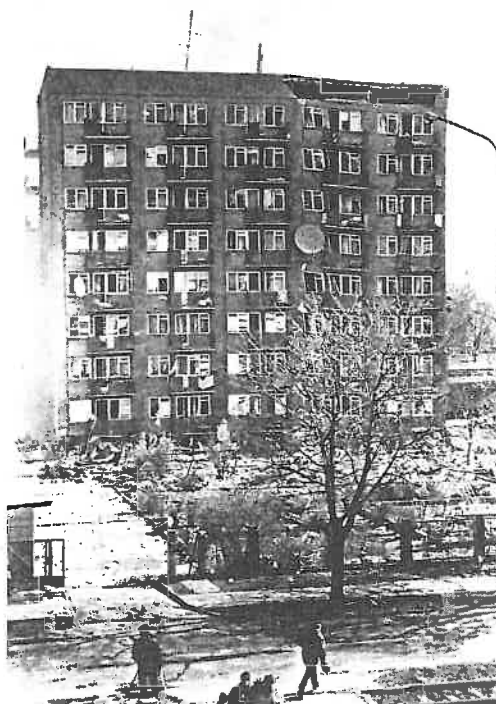
Rys. 7. Elewacja główna uszkodzonego budynku od strony Alei Wojska Polskiego
